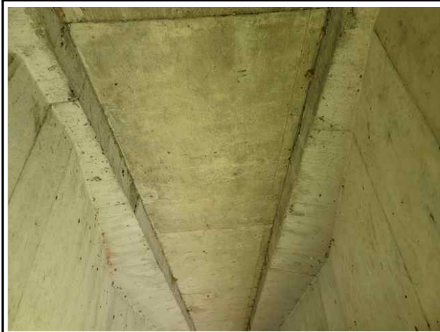
바닥판 S1 균열
