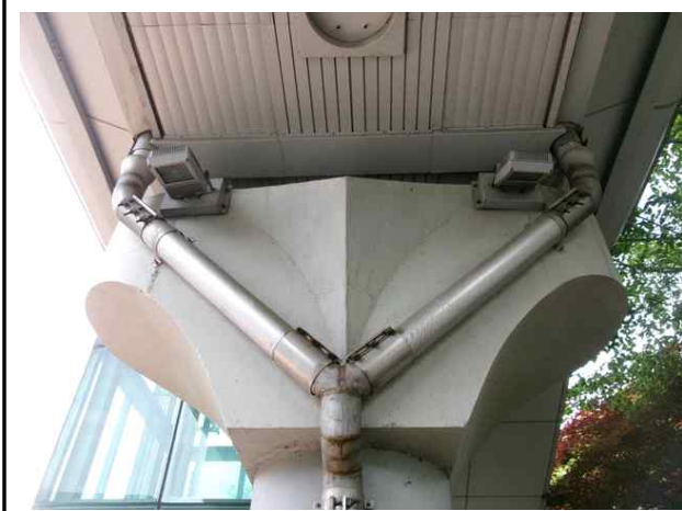
교각 P2 균열
