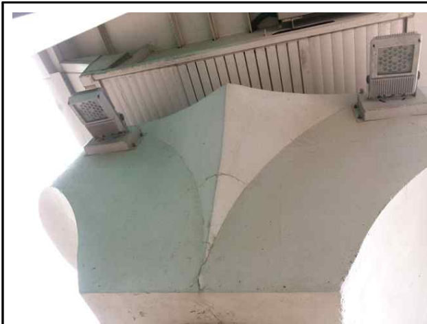
교각 P1 균열
