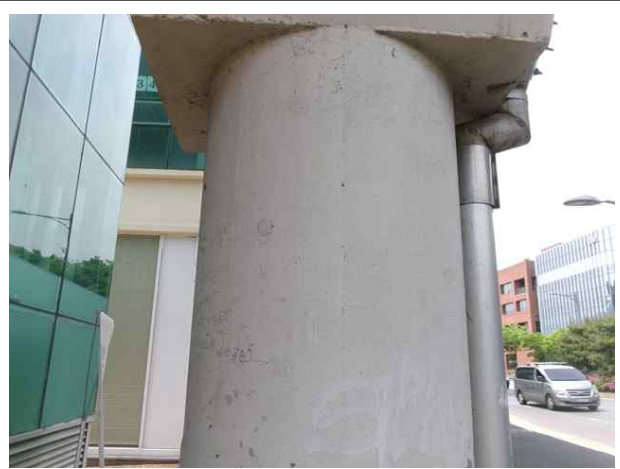
교각 P1 망상균열
